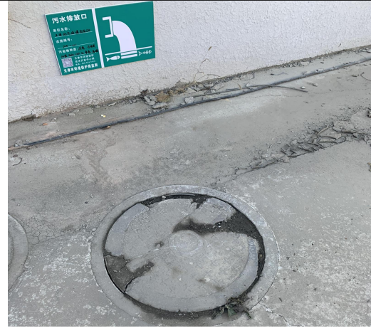
2#污水总排口标识（4#厂房外西侧）
